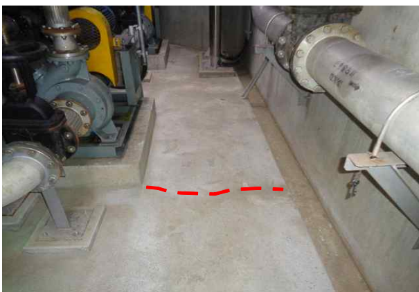
내부 지하층 바닥 균열 (CW=0.2mm, L=1.0m)
