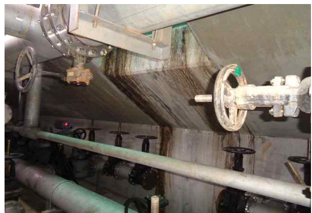
내부 지하층 벽체 백태 및 누수흔적 (A=3.0m×2.0m)
