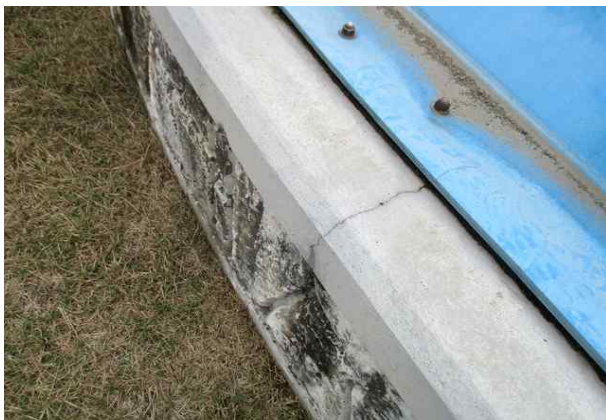
1지 외부 벽체 상면 균열 (CW=0.1mm, L=0.5m, 42EA)
