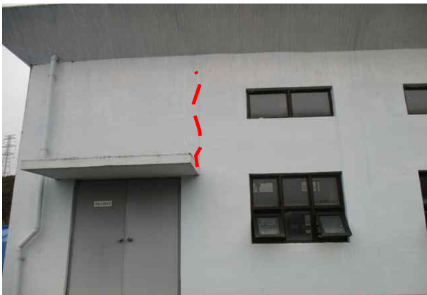
외부 벽체 균열 (CW=0.1mm, L=2.0m)
