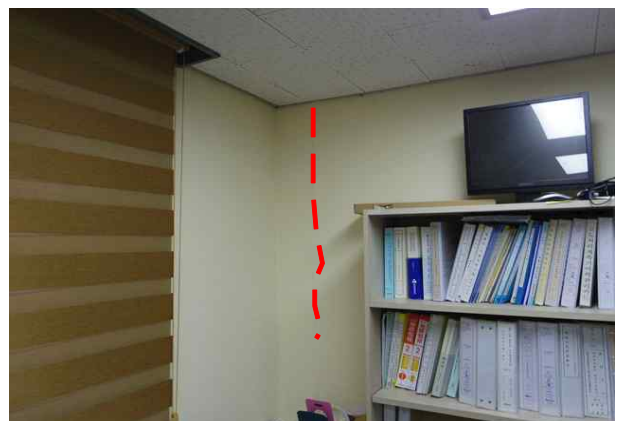
내부 2층 벽체 균열 ( CW=0.2mm , L=3.0m )
