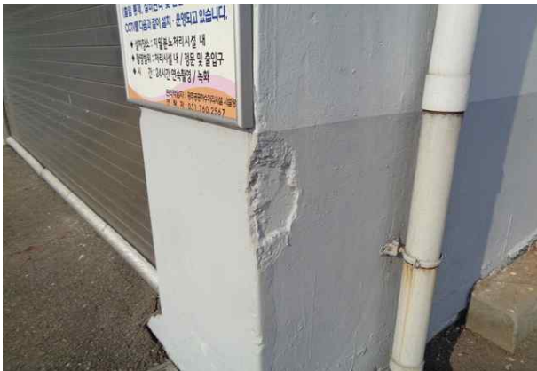
외부 벽체 콘크리트 파손 (A=0.1m×0.3m)
