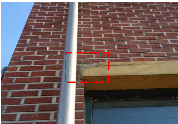
외부 벽체 콘크리트 파손 (A=0.1m×0.1m)
