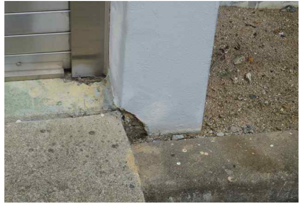
외부 벽체 콘크리트 박락 ( A=0.1\text{m}\times0.1\text{m} )
