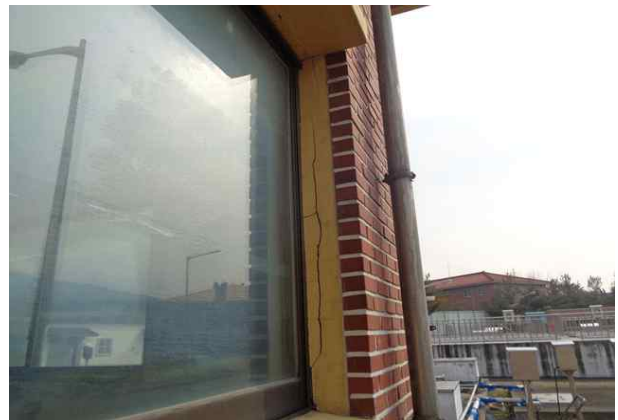
외부 벽체 균열 ( CW=0.3\text{mm} , L=1.5\text{m} )
