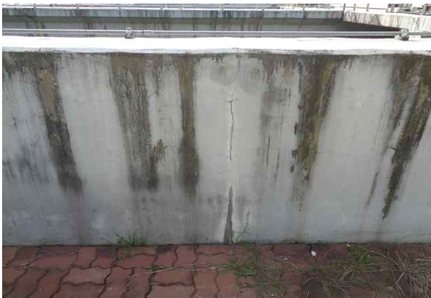
외부 벽체 균열 및 백태 (L=1.0m, 5EA)
