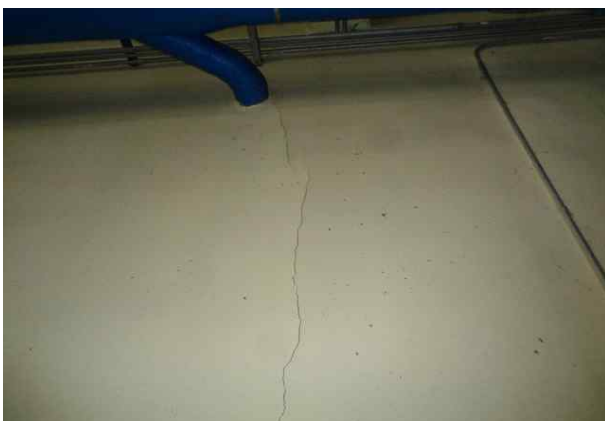
내부 벽체 균열 (CW=0.5mm, L=4.0m)
