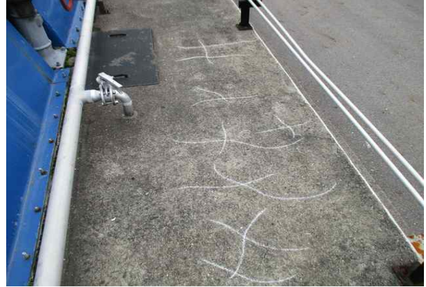
외부 바닥 망상균열 (A=1.0m×1.5m)
