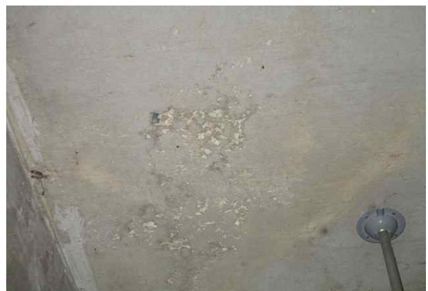
내부 지하층 천장 재료분리 (A=0.3m×0.5m)
