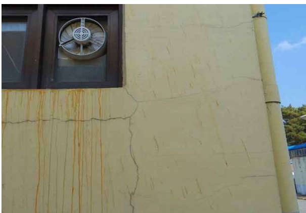
외부 벽체 균열 (CW=0.2mm, L=4.0m, 15EA)
