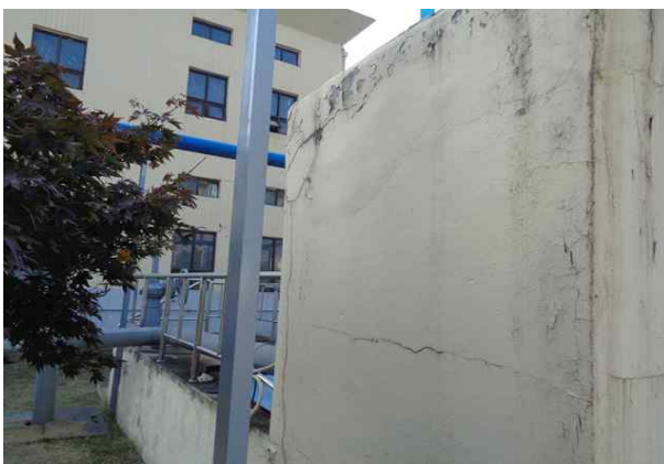
농축분배조 외부 벽체 균열 및 표면박리 (A=1.5m×0.5m)
