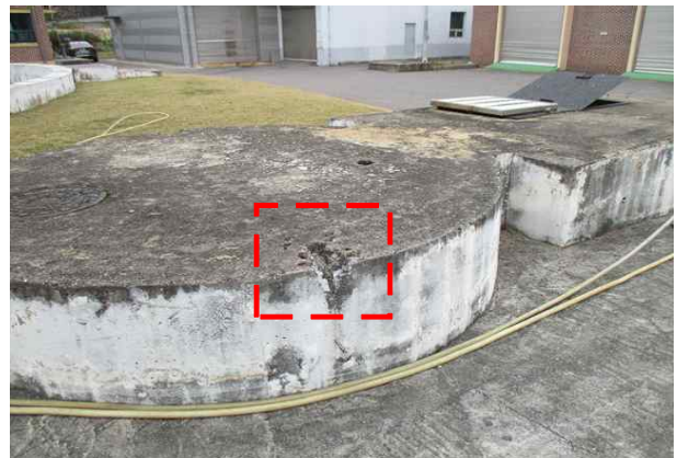
외부 벽체 콘크리트 파손 (A=0.2m×0.5m)
