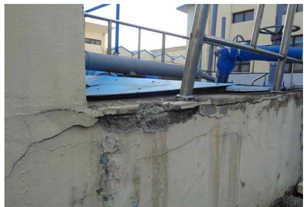
농축분배조 외부 벽체 콘크리트 파손 (A=0.5m×0.2m)
