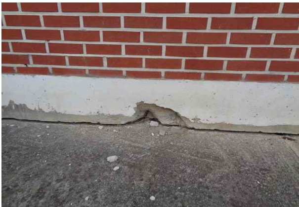
외부 벽체 콘크리트 파손 ( A=0.3\text{m} \times 0.2\text{m} )
