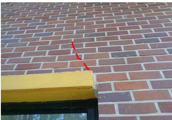
외부 벽체 균열 (CW=0.1mm, L=0.3m)
