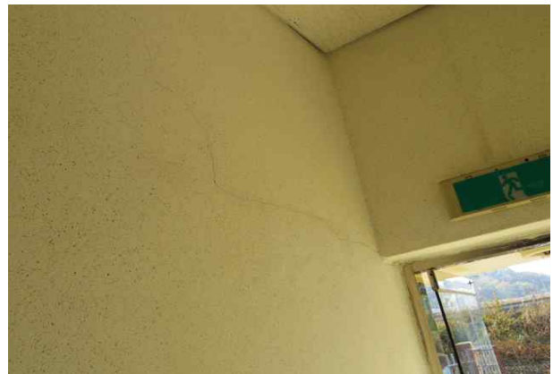
내부 1층 벽체 균열 ( CW=0.2\text{mm} , L=2.0\text{m} )
