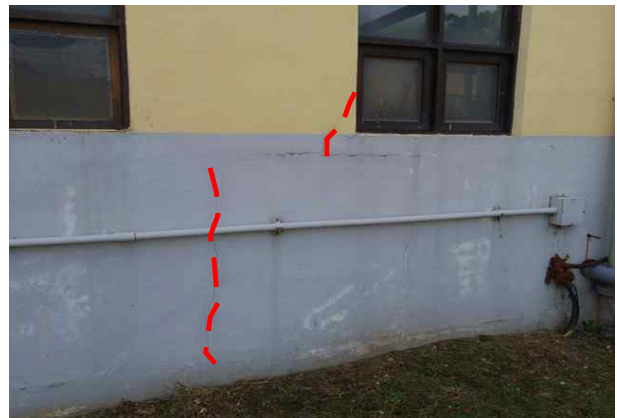
외부 벽체 균열 (CW=0.3mm, L=3.5m, 7EA)
