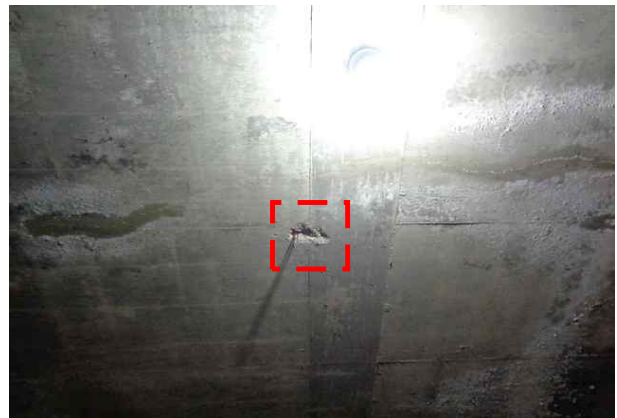
내부 천장 콘크리트 파손 (A=0.1m×0.2m)
