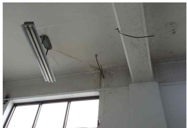
내부 벽체 누수흔적 (A=0.5m×1.0m)
