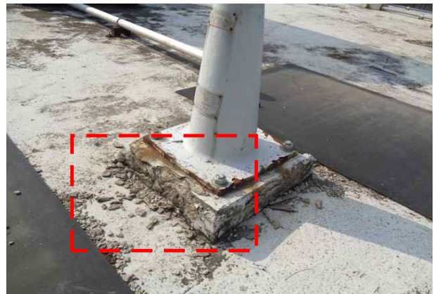
외부 바닥 콘크리트 박락 (A=0.5m×0.5m)
