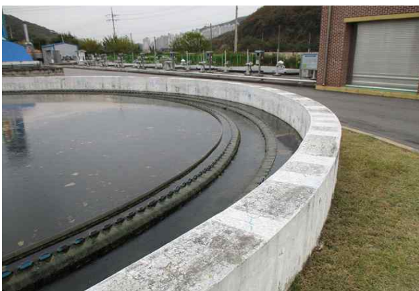
2지 외부 벽체 도장박리 및 망상균열 (A=52.0m×1.5m)
