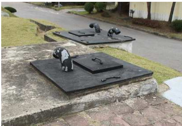
외부 바닥 콘크리트 박리 및 파손 (A=0.3m×4.0m)
