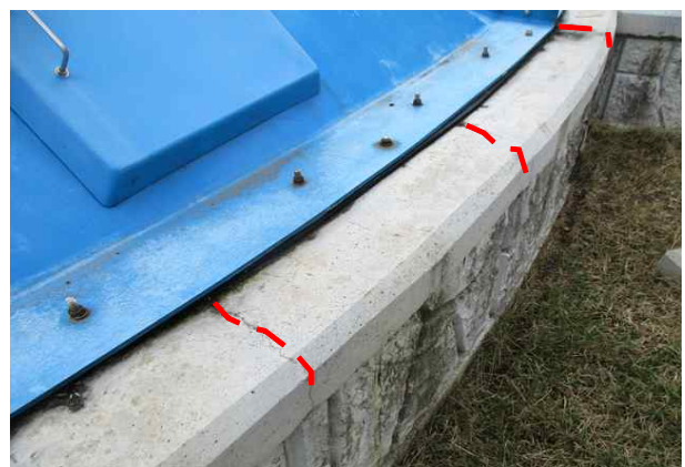
2지 외부 벽체 상면 균열 (CW=0.1mm, L=0.3m, 40EA)
