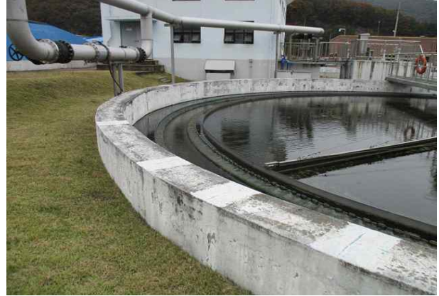
1지 외부 벽체 도장박리 및 망상균열 (A=52.0m×1.5m)
