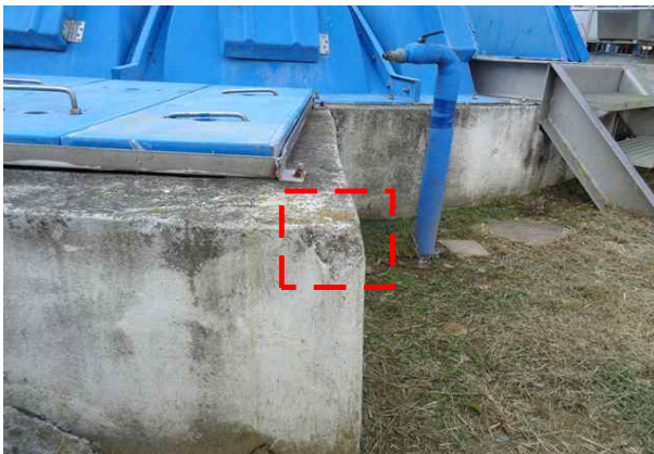
농축조 외부 바닥 콘크리트 파손 (A=0.1m×0.1m)
