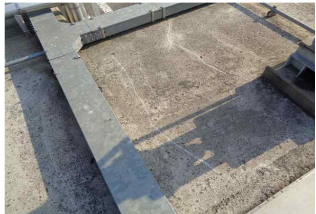
외부 바닥 균열 (CW=0.2mm, L=1.5m, 2EA)
