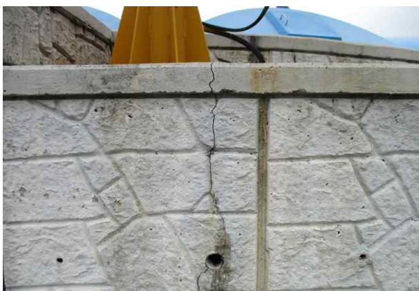
외부 웅벽 균열 (CW=0.5mm, L=1.0m)
