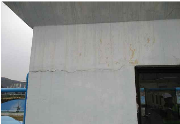
외부 벽체 균열 (CW=0.2mm, L=1.0m)
