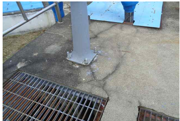
농축분배조 외부 바닥 들뜸 및 박리 (A=1.0m×2.0m)
