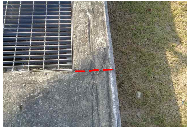
외부 바닥 균열 (CW=0.2mm, L=1.0m)
