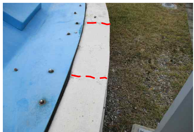
1지 외부 벽체 상면 균열 (CW=0.2mm, L=0.3m, 22EA)
