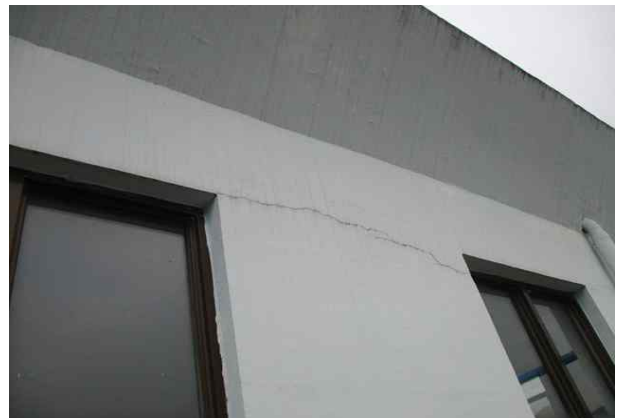
외부 벽체 균열 (CW=0.2mm, L=1.5m)
