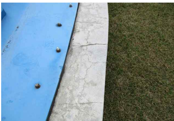
2지 외부 벽체 상면 균열 (CW=0.1mm, L=0.3m, 66EA)
