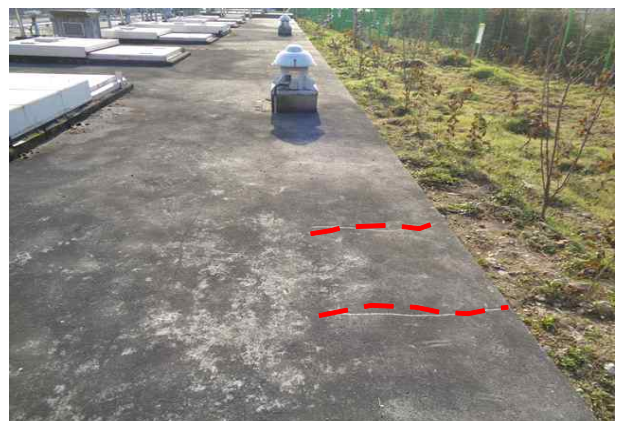
외부 바닥 균열 (CW=0.2mm, L=2.5m, 4EA)
