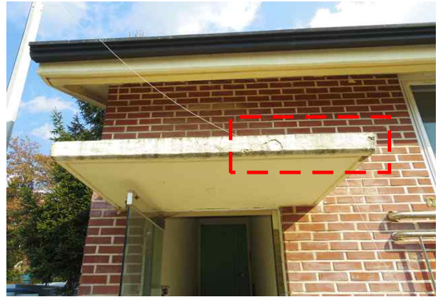
외부 출입구 콘크리트 들뜸 ( A=1.0\text{m} \times 1.0\text{m} )
