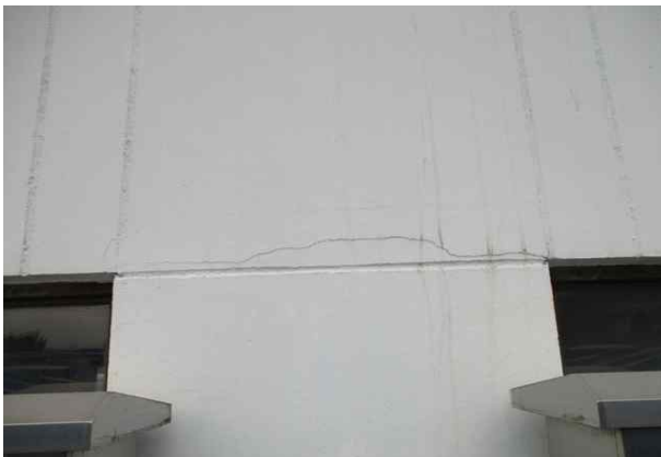
외부 벽체 균열 (CW=0.1mm, L=1.0m)
