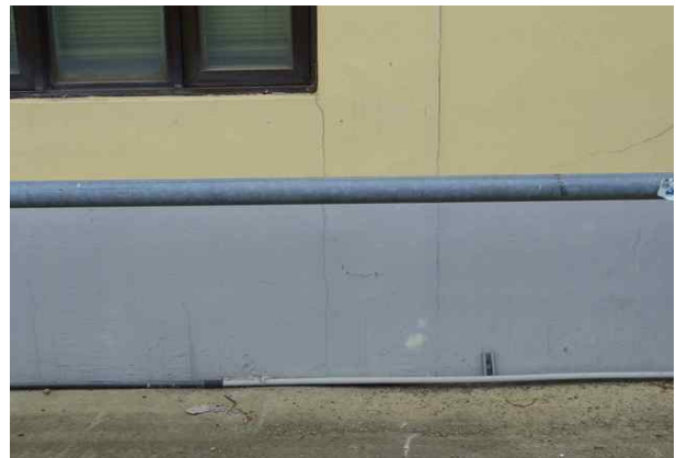
외부 벽체 균열 (CW=0.2mm, L=1.0m, 15EA)
