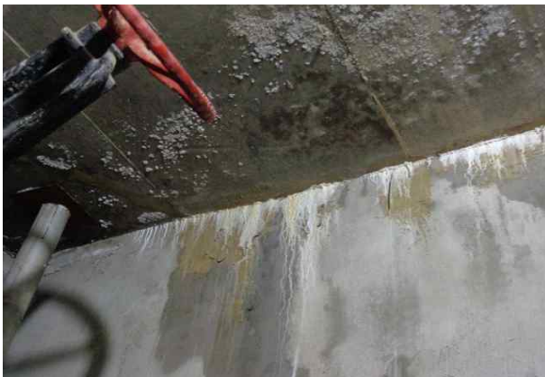
내부 벽체 누수 및 백태 (A=0.5m×4.0m)
