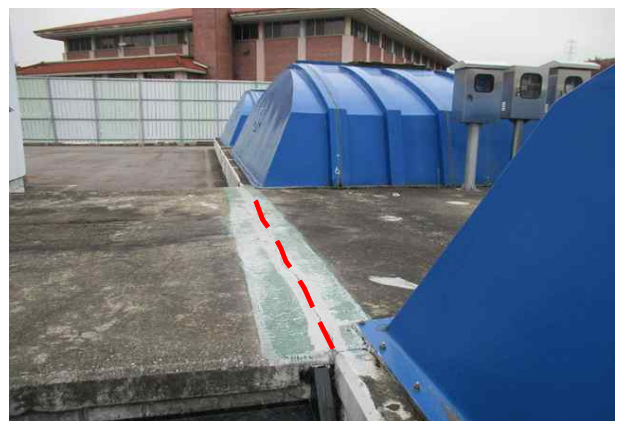
외부 바닥 실링재 파손 (A=0.1m×2.0m)
