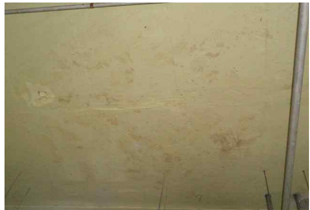
내부 지하층 천장 도장박리 (A=7.0m×11.0m)
