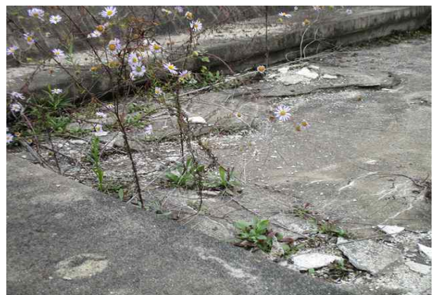
옥상층 바닥 박리 및 들뜸 (A=5.5m×5.5m)
