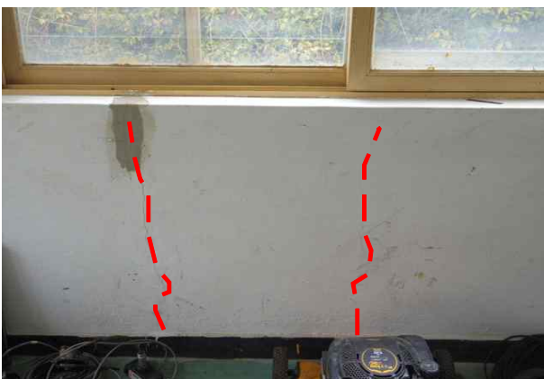
내부 벽체 균열 ( CW=0.2\text{mm} , L=1.0\text{m} , 2EA)
