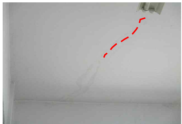
내부 천장 균열 및 누수흔적 (A=0.1m×0.5m)
