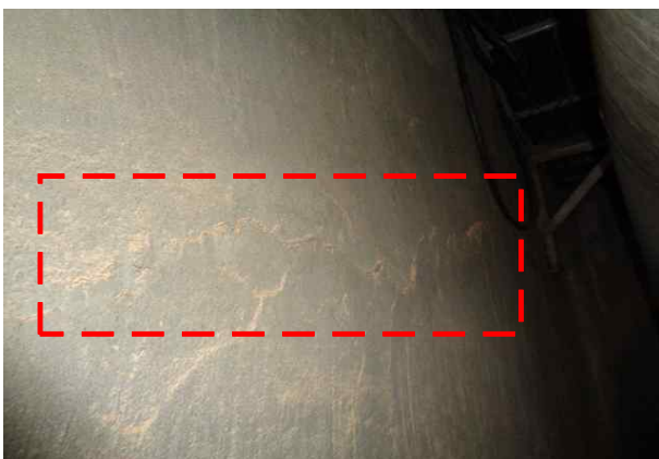
내부 지하층 벽체 균열 및 박리 (L=4.0m)
