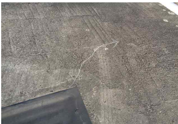
외부 바닥 균열 (CW=0.2mm, L=1.0m)
