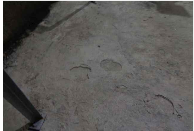
내부 바닥 마감재 박리 (A=4.0m×25.0m)
