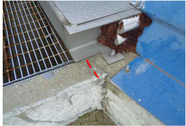
농축조 외부 바닥 균열 (CW=0.3mm, L=0.2m)
