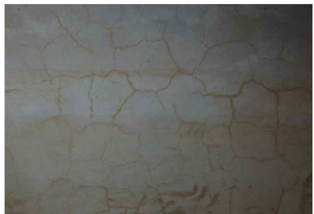
내부 지하층 벽체 망상균열 ( A=300.0\text{m} \times 2.5\text{m} )
